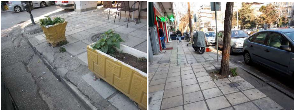
Εικόνες 14, 14α: ΦΘΟΡΕΣ ΠΛΑΚΟΣΤΡΩΣΗΣ
