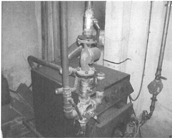
Εικόνα 3 Λέβητας φυσικού αερίου με τετράοδη χειροκίνητη βάνα.
