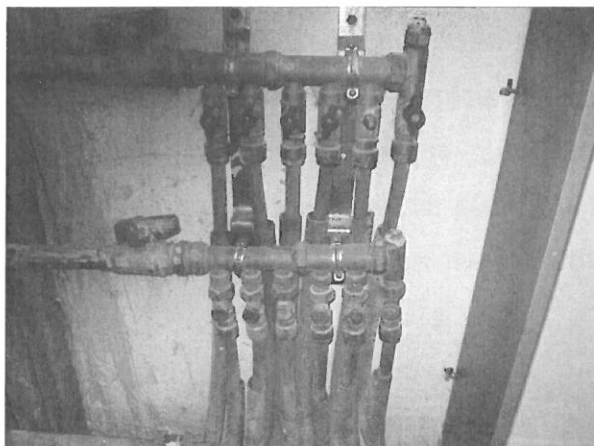
Εικόνα 4 Πίνακας διανομής ενδοδαπέδιας.
