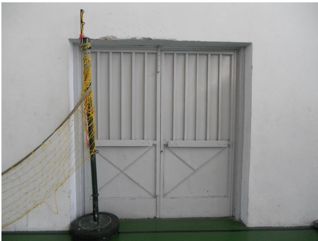
Εικόνα 27 Πόρτα που θα αποξηλωθεί
