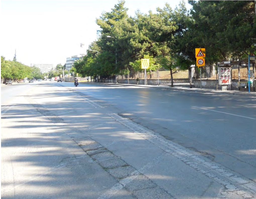
ΦΩΤ. 2.3 Κακή κατάσταση οδοστρώματος στη θέση της παλιάς νησίδας μπροστά στο πρώην 424 Στρατιωτικό Νοσοκομείο
